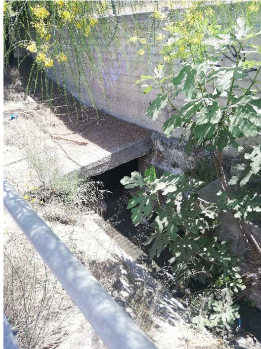
Φωτογραφία Φ6. Εκβολή εγκάρσιων αγωγών ΗΣΑΠ επί της Λεωφ. Ηρακλείου
