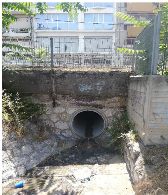
Φωτογραφία Φ5. Εκβολή εγκάρσιων αγωγών ΗΣΑΠ επί της Λεωφ. Ηρακλείου
