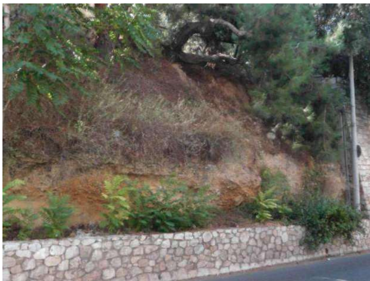
Φωτ. 7: Θέση πρानούς επί της οδού Σαρανταπήχου, το οποίο παρουσιάζει ενδείξεις εδαφικών ασταθειών.
