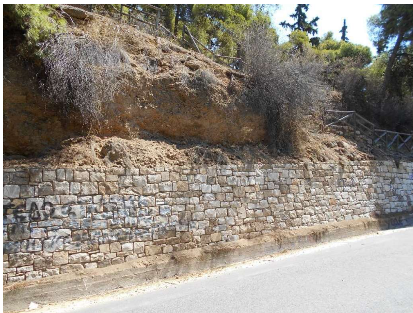
Φωτ.21. Συσσώρευση μικρού όγκου αμμο-χαλικωδών υλικών διάβρωσης επί της υφιστάμενης λιθοδομής και του ρείθρου του πεζοδρομίου.
