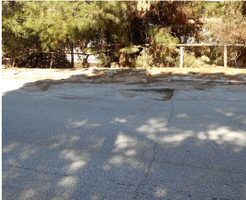
Φωτ.18. Θραύσεις – “ζυμώματα” του ασφαλτικού της οδού για το Λόφο του Λυκαβητού.
