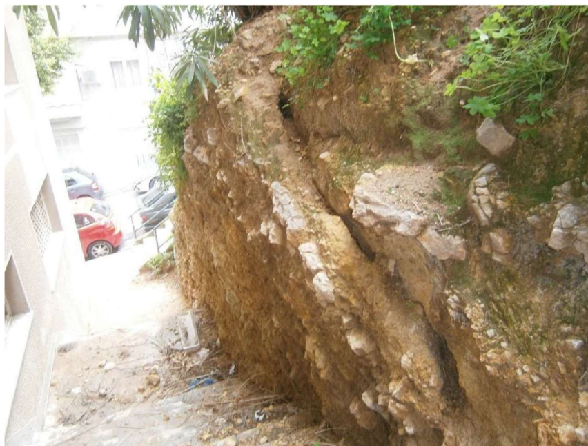
Φωτ.13. Χαίνουσα διάκλαση στο νότιο τμήμα του πρανούς που διευκολύνει ανατροπές τμήματος της βραχομάζας μέσου πάχους 0.40m.
