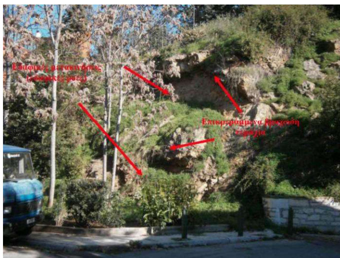
Φωτ. 1: Άποψη του ΒΑ/κού τμήματος του πρανούς, διακρίνονται τμήματα στα οποία έχουν εκδηλωθεί εδαφικές καταπτώσεις προκαλώντας ταυτόχρονα υποσκαφή σε γειτονικά βραχώδη τεμάχια.
