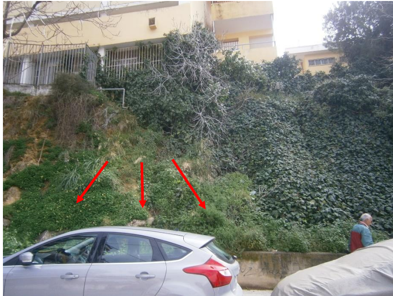
Φωτ. 5: Άποψη του δεύτερου τμήματος (συμβολή των οδών Πυθίας και Νικάνορος), διακρίνεται η πίσω πλευρά του σχολικού κτιρίου και η ζώνη των καταπτώσεων στην όψη του πρανούς.
