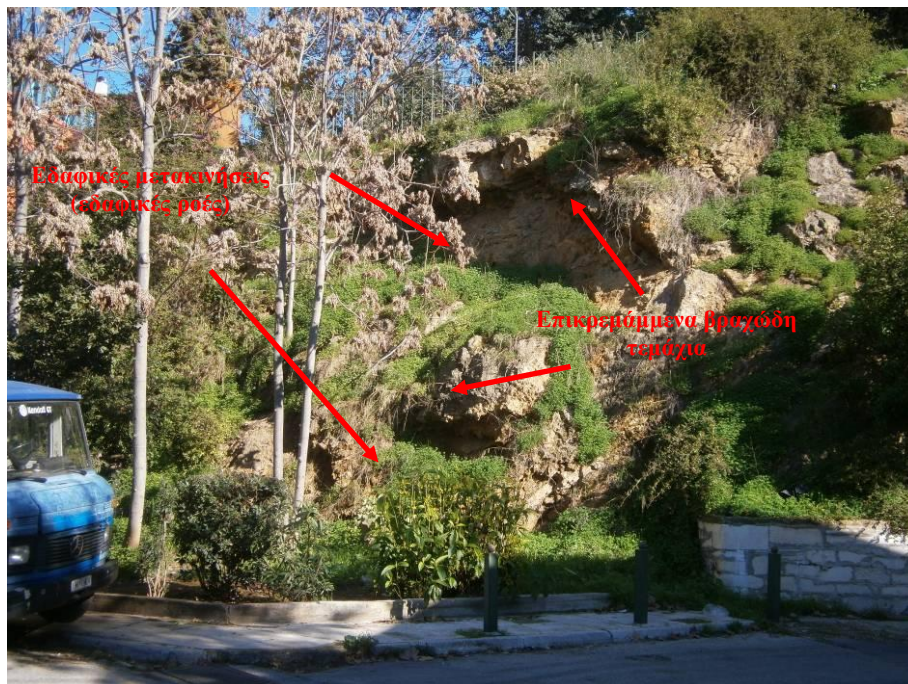
Φωτ. 1: Άποψη του ΒΑ/κού τμήματος του πρανού, διακρίνονται τμήματα στα οποία έχουν εκδηλωθεί εδαφικές καταπτώσεις προκαλώντας ταυτόχρονα υποσκαφή σε γειτονικά βραχώδη τεμάχια.
