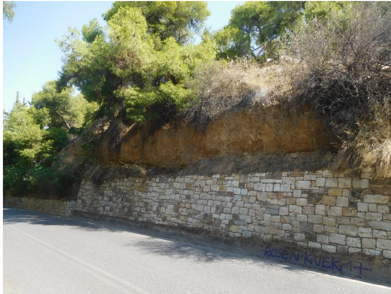
Φωτ. 15: Θέση μικρο-καταπτώσεων σε πρανές επί της οδού Ρογκάκου.
