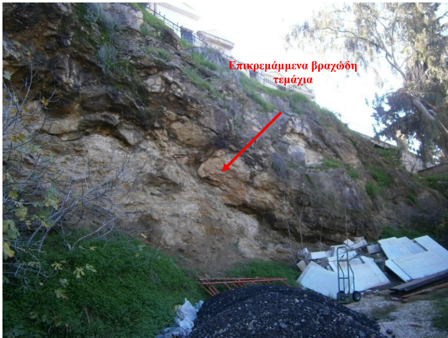
Φωτ. 2: Άποψη του ΝΑ/κού τμήματος του πρανούς, διακρίνονται τα επικρεμάμενα βραχώδη ασβεστολιθικά τεμάχια .
