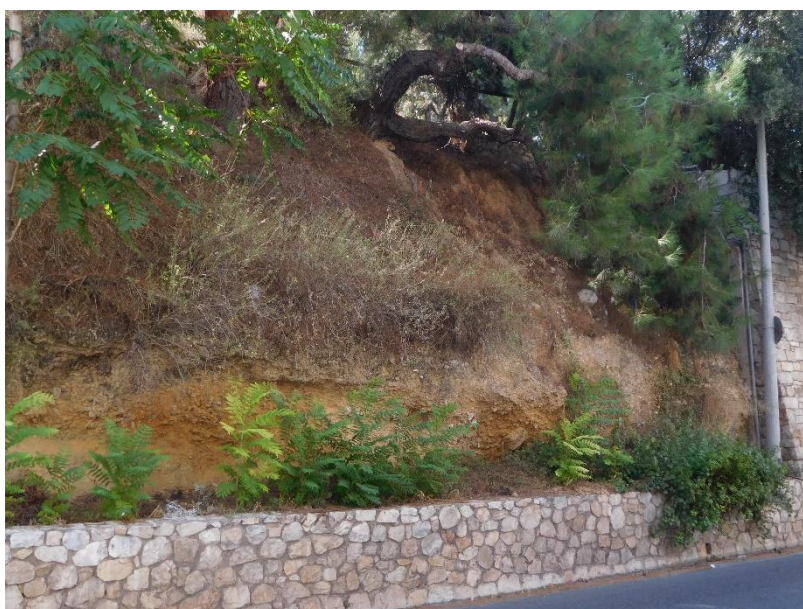
Φωτ. 12: Θέση πρανούς επί της οδού Σαρανταπήχου, το οποίο παρουσιάζει ενδείξεις εδαφικών ασταθειών.
