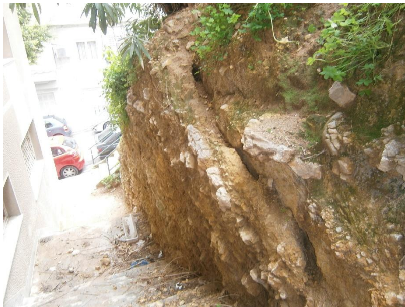
Φωτ. 8: Πρανές στην οδό Μπουκουβάλα, τμήμα πρανούς έτοιμο για αποκολληθεί και να αστοχήσει.
