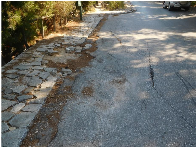
Φωτ. 14: Ρωγμή – άνω όριο εδαφικής αστάθειας.
