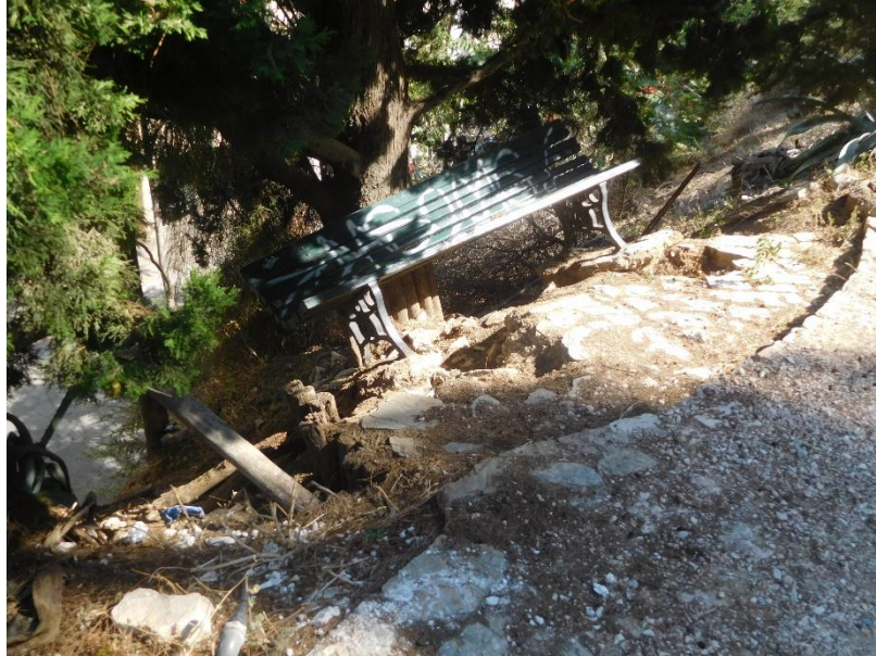
Φωτ. 13: Ενδείξεις εδαφικής αστάθειας στο ανώτερο τμήμα του πρανούς επί της οδού Σαρανταπήχου.
